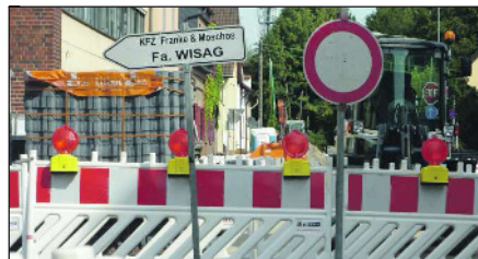
Die Zufahrt zum KFZ-Meisterbetrieb Franke und Kakavours ist nur über eine Umleitung möglich, die über einen Feldweg führt.
