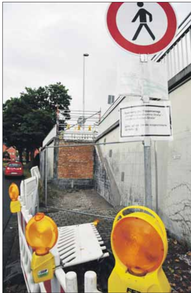
Die Treppe von der Bushaltestelle am Tor West zum Werkstor ist abgerissen. Für einen Ersatzbau gibt es noch keinen Termin. Foto: Sittig
